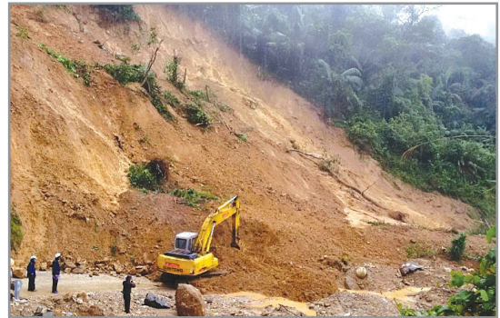
Hình 9.14. Sạt lở đất do mưa lớn ở Kon Plông (Ảnh: Khoa Điềm)
