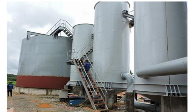
Hình 9.6: Hệ thống xử lý nước thải nhà máy sản xuất tinh bột sắn (Ảnh: Thiên Hương)
